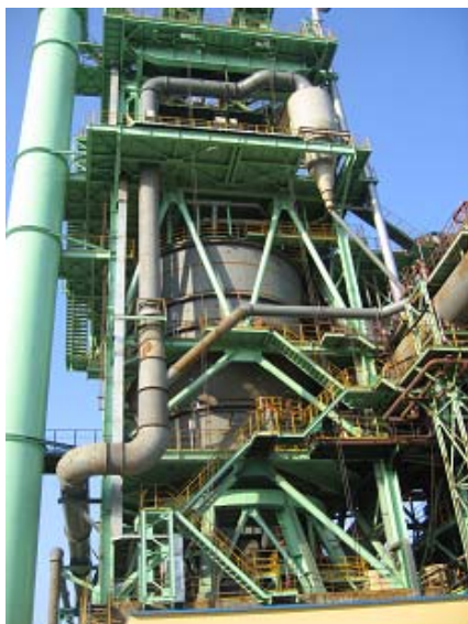
干熄焦余热锅炉
