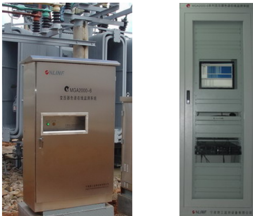
MGA2000-6 型变压器色谱在线监测系统运行现场和后端控制柜
