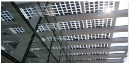
双玻璃光伏屋顶
