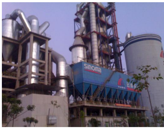
水泥窑尾袋式除尘器 (建材行业. 云浮水泥)
