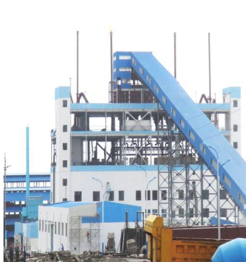
节能环保密闭矿热炉实景
