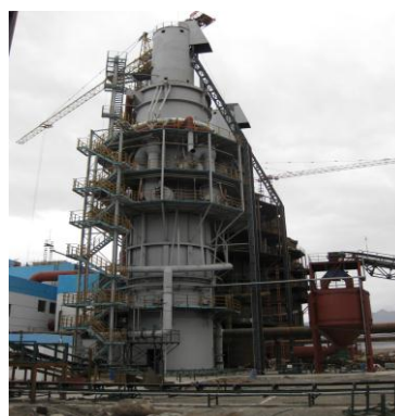
炉气高温净化与回收利用系统
