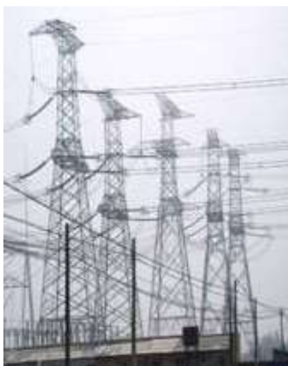
500KV 输电线路铁塔
