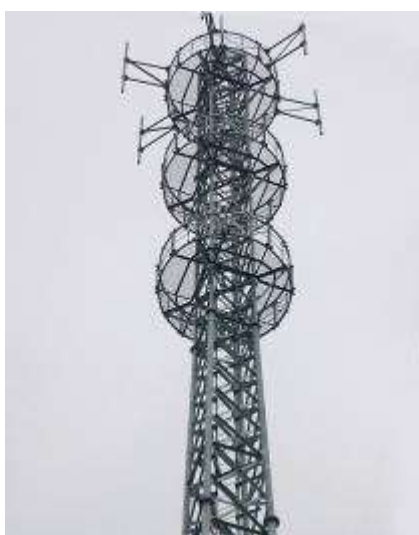
中国移动通信公司常熟移动四管组合塔
