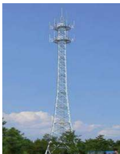
中国联通内蒙古公司通信角钢塔
