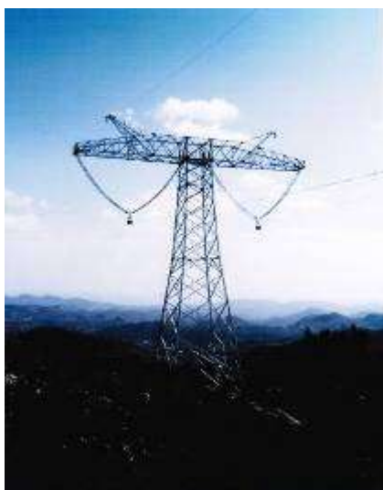
特高压输电线路铁塔
