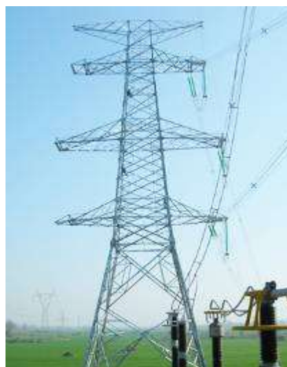
220KV 输电线路铁塔
