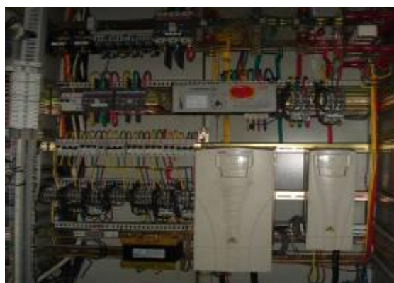
致君制药中央空调末端变风量系统
