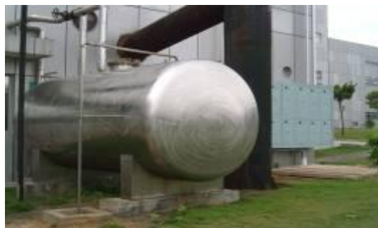
致君制药热水、蒸汽、凝结水回收项目
