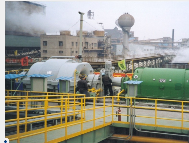
陕鼓历史上第一个工程总承包项目——上海宝钢2500立方米高炉TRT装置工程总承包项目
