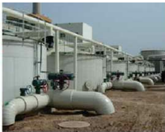
空气擦洗滤池
