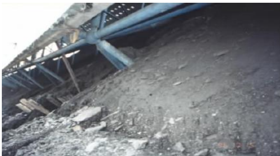
煤棚煤不正常堆煤现象
