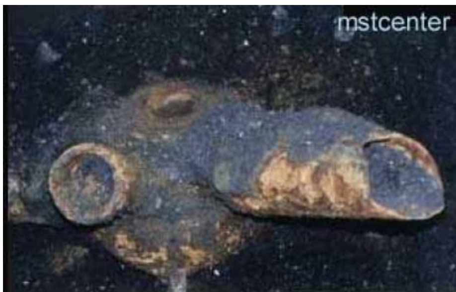
节点和杆件锈蚀破坏
