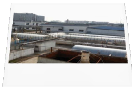
污水臭气吸收装置
