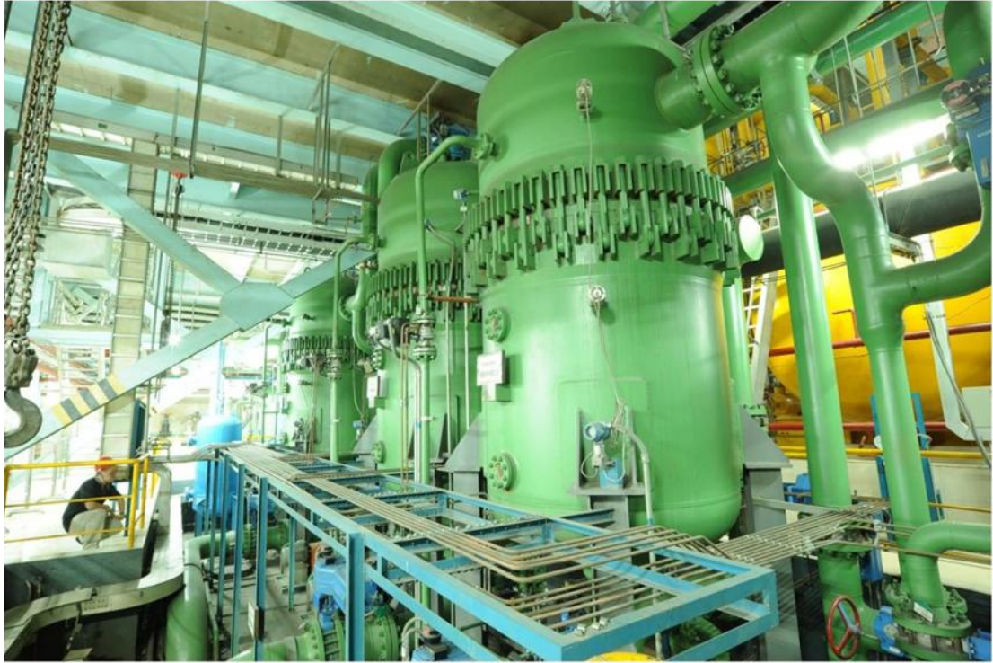
图片：中国国电集团山西大同发电有限公司凝结水精处理项目
