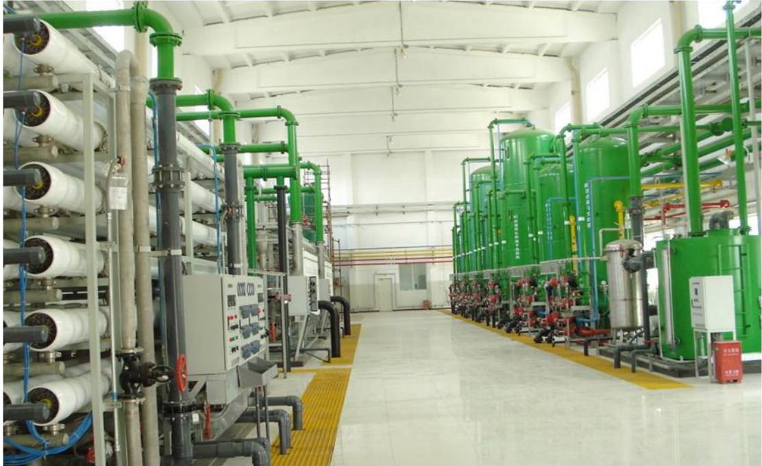
图片：锅炉补给水处理系统在电力行业的应用
