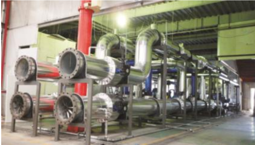
水冷商用空调主机试验装置
