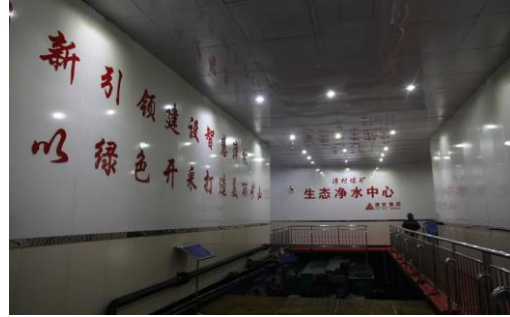
潞安集团漳村煤矿井下水处理项目
