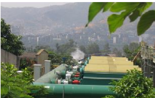
单位占地面积处理效率最高的 攀钢集团热轧工程水处理项目
