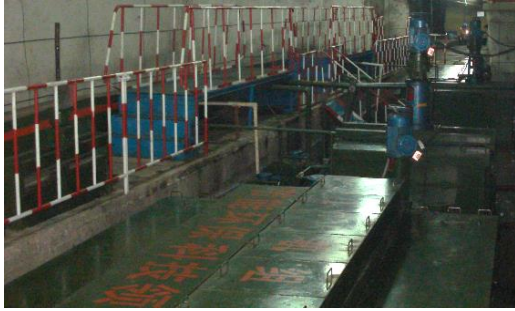
国内首个矿井水磁分离井下处理工程—山东能源集团新汶矿业协庄煤矿井下水处理项目
