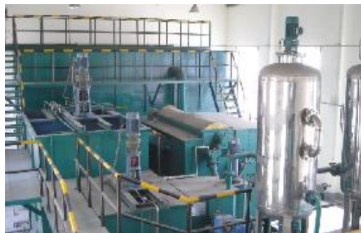
山西长治电厂循环水处理项目
