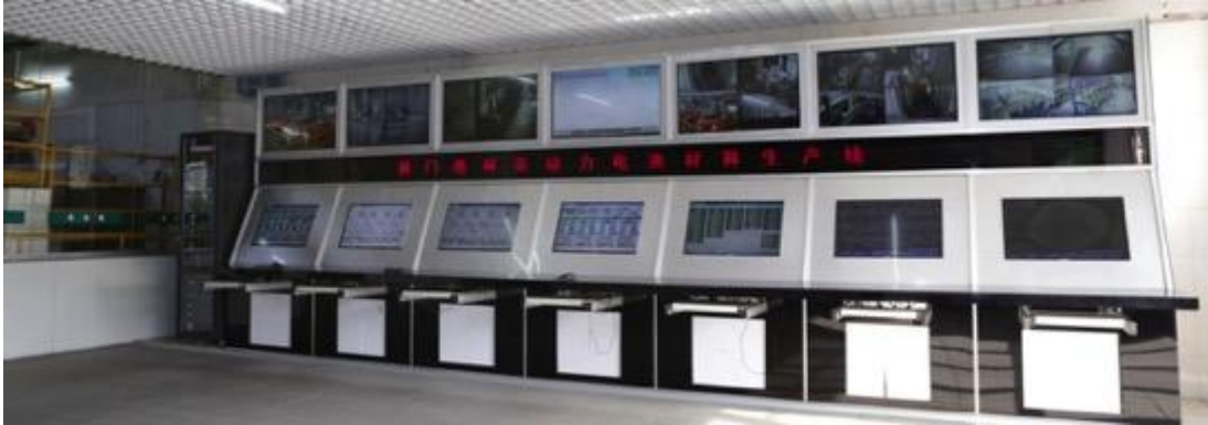
格林美动力电池材料生产线 PLC 自动控制系统
