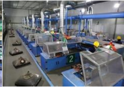
CRT 切割负压室集尘系统
