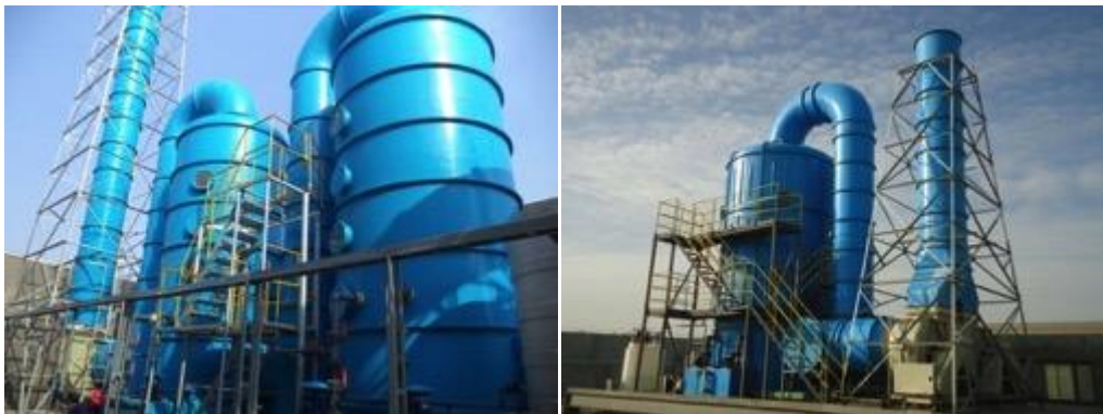
稀贵车间酸气吸收塔 电池材料三车间氨气回收系统
