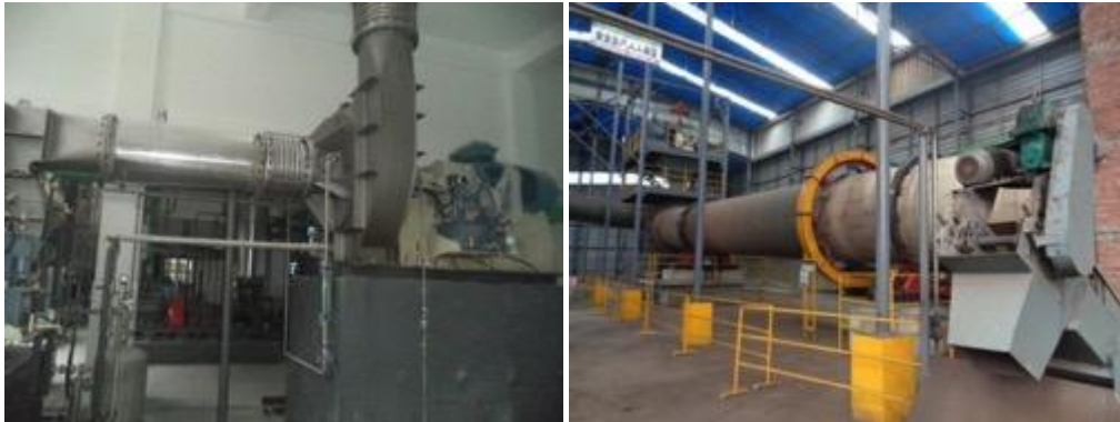
氯化铵废水 MVR 蒸发结晶系统废渣回转烘干机
