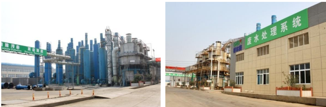
先进的废水处理系统
