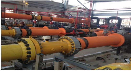
调压站（大唐北京高井热电厂）
