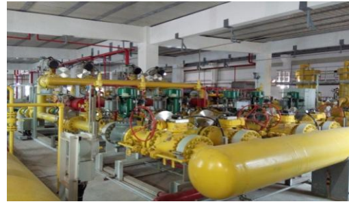
调压站（天津陈塘庄燃气电厂）
