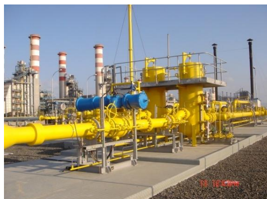
调压站（阿联酋特维拉联合循环电厂）
