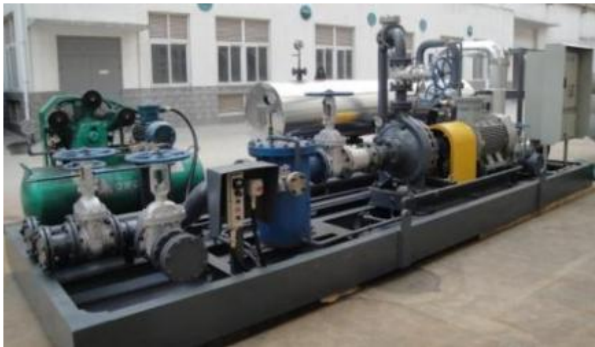
大型储油罐机械清洗成套设备的回收设备
