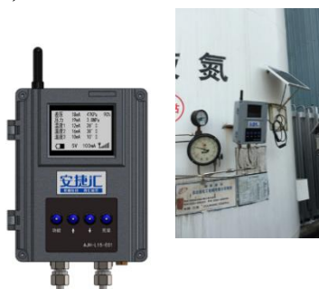
安捷汇贮罐液位智能监控装置
