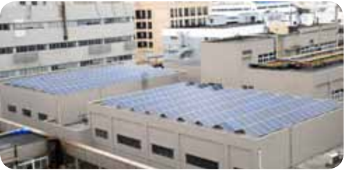
分布式光伏发电项目
