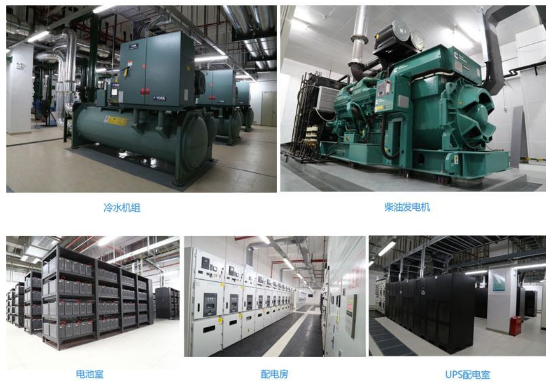
图 1：盘古数据中心机房及相关设备
