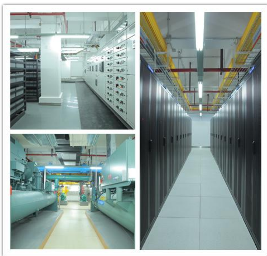
图 7：9 号互联网数据中心机房及设备
