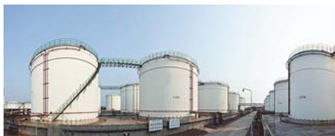
聚酯油品储罐
