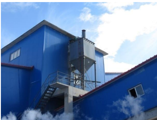
多宝山铜业选矿车间除尘器
