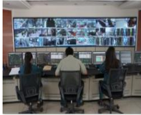
管道远程控制中心
