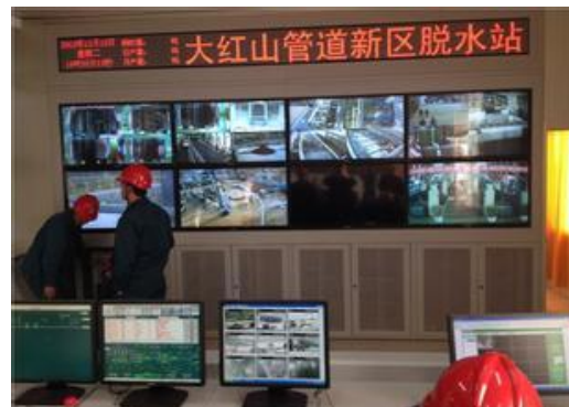
脱水站远程控制室
