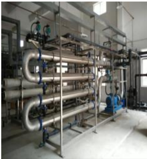
渗滤液外置式 MBR 系统
