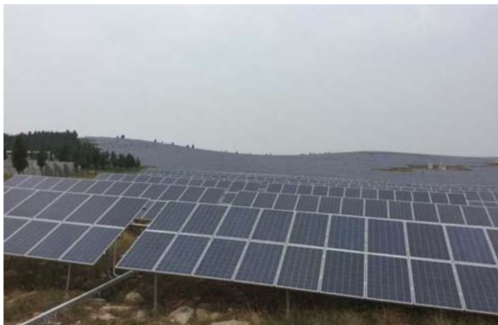
安徽宿州埇桥区解集乡 40MW 地面分布式光伏发电项目
