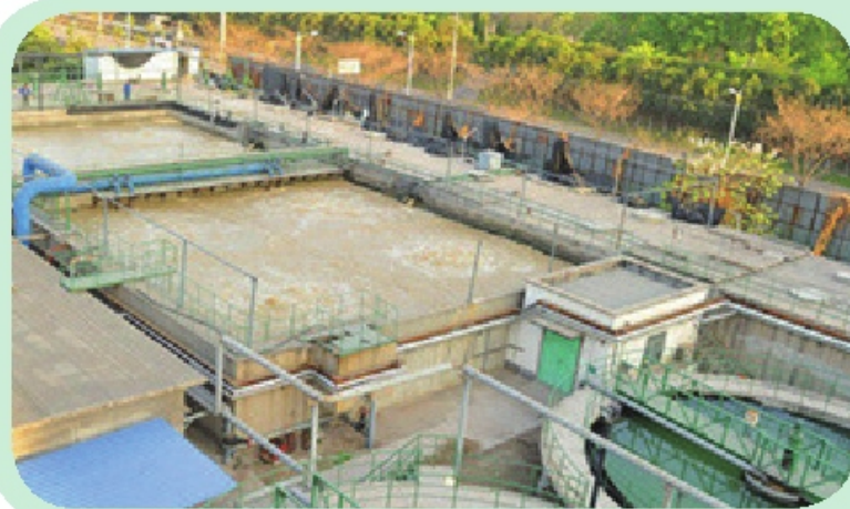
神马股份污水生化水处理系统
