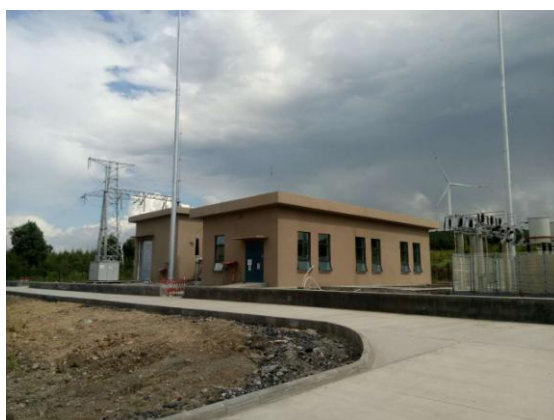
风电场共用升压站
