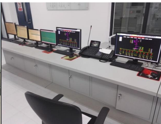
风电场共用监控室
