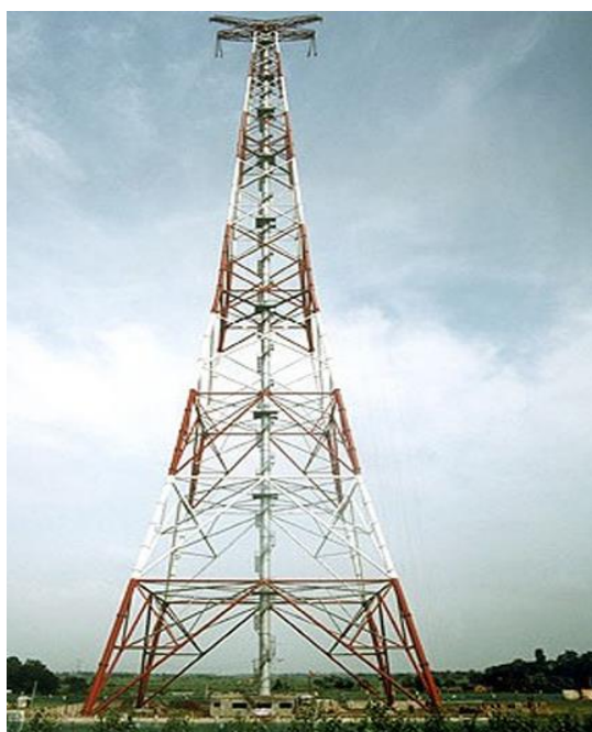
大跨越钢管塔
