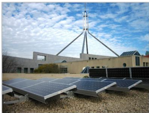
澳洲国会大厦的光伏屋顶电站项目
