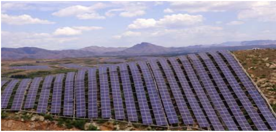
荒坡光伏阵列
