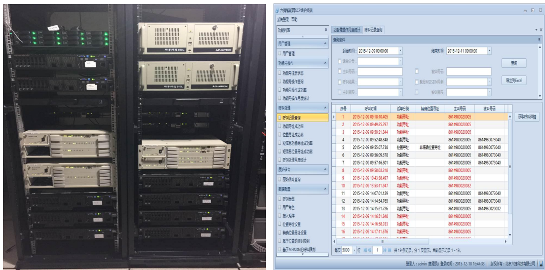
(5) 机车同步操控系统 AN 节点、OCU 软件
