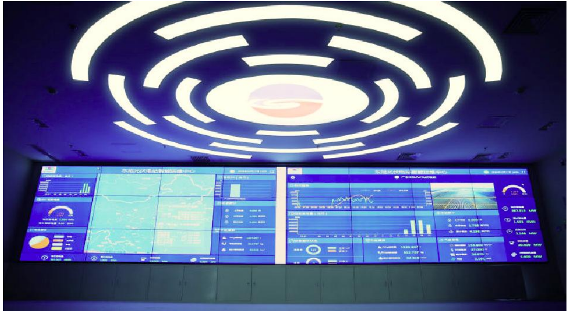
公司光伏电站智能运维管理平台
