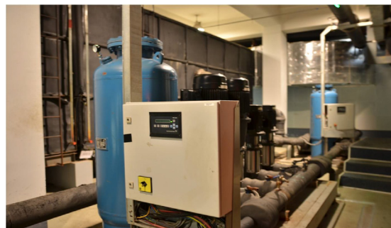
国家会议中心中水机房设备
