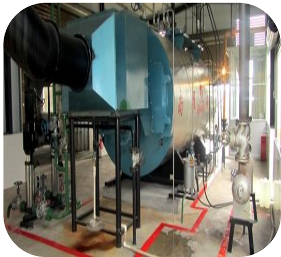
改造后的燃气锅炉
