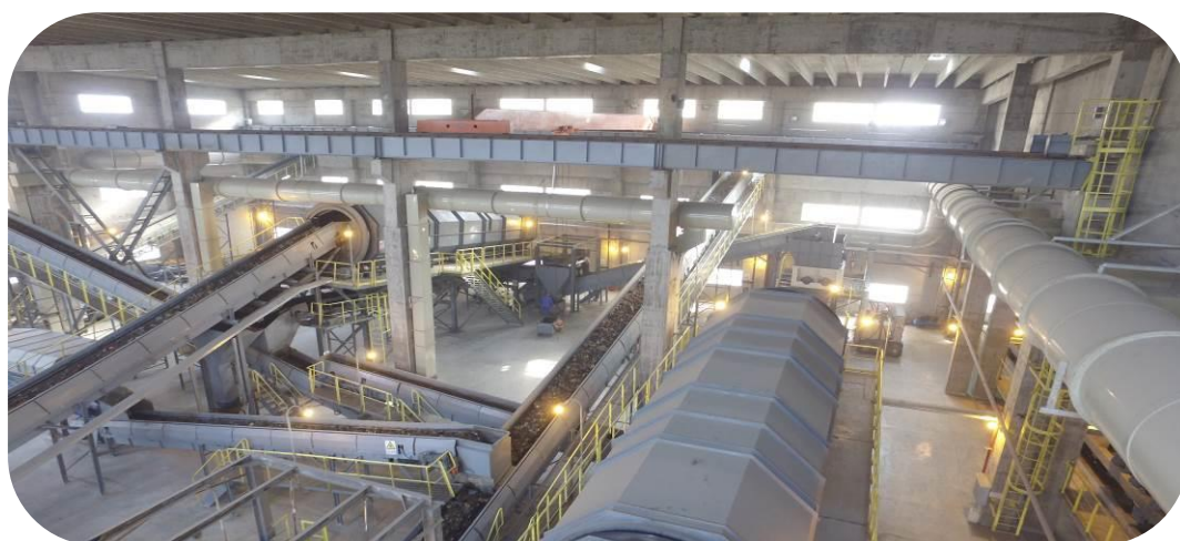
水泥窑协同处置城市生活垃圾老河口示范线
