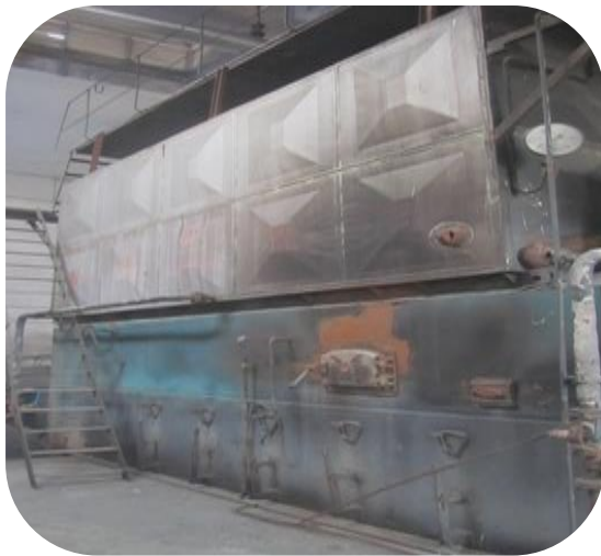
改造前的燃气锅炉
