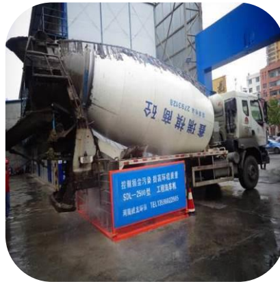
6. 混凝土罐车自动冲洗设备
