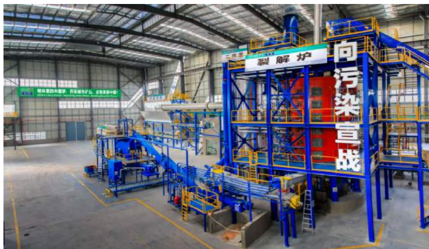
废线路板绿色处理线
