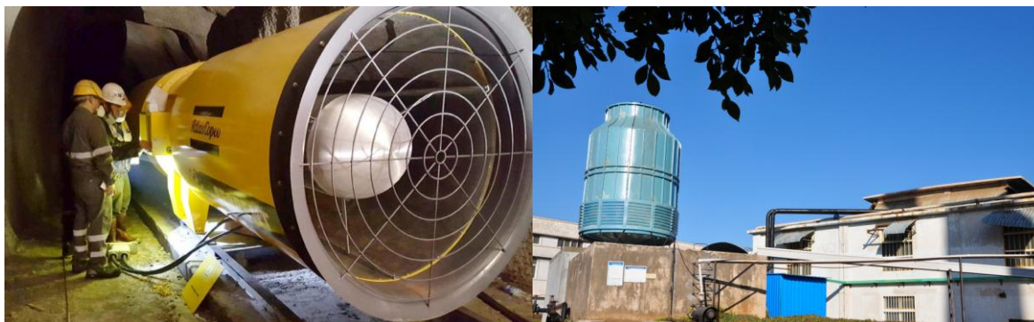
无轨平巷新风机解决尾气污染问题
