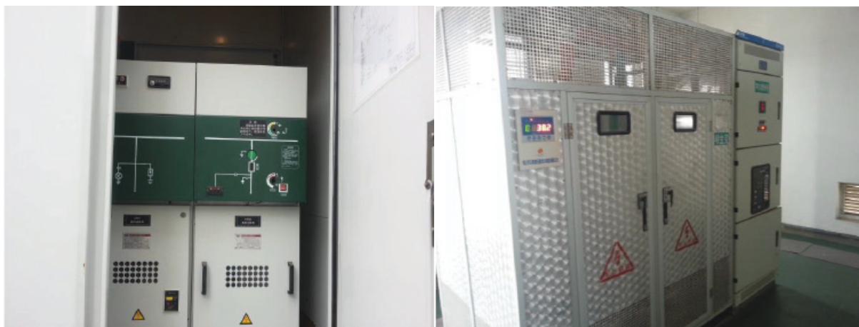
圖6.3廠區廠房設備示例 (典型光伏陣列支架系統及換流器系統)
