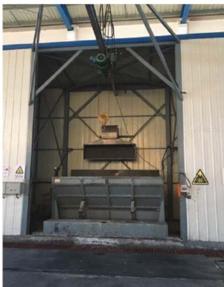
預處理進料口
