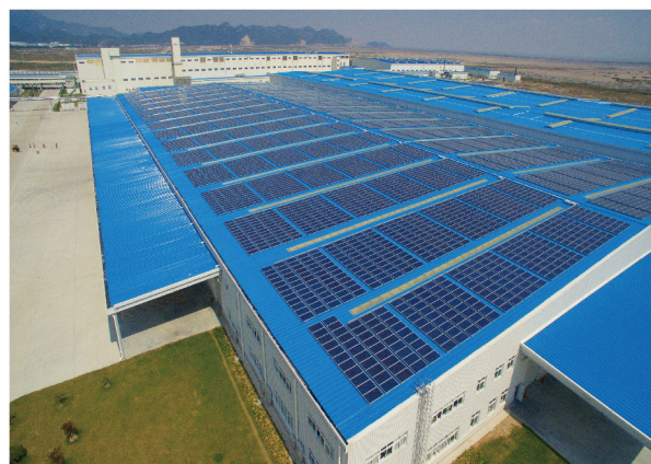
吉利路虎太阳能光伏屋顶项目
