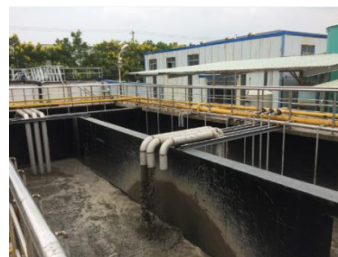
污水处理厂污泥减量化
