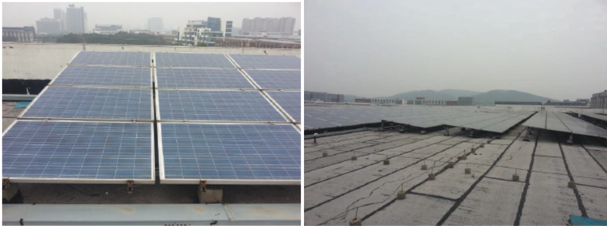
圖6.4 光伏組件陣列
