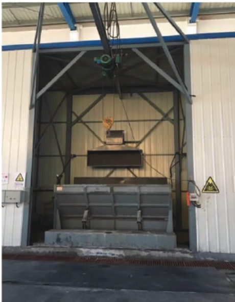
預處理進料口
