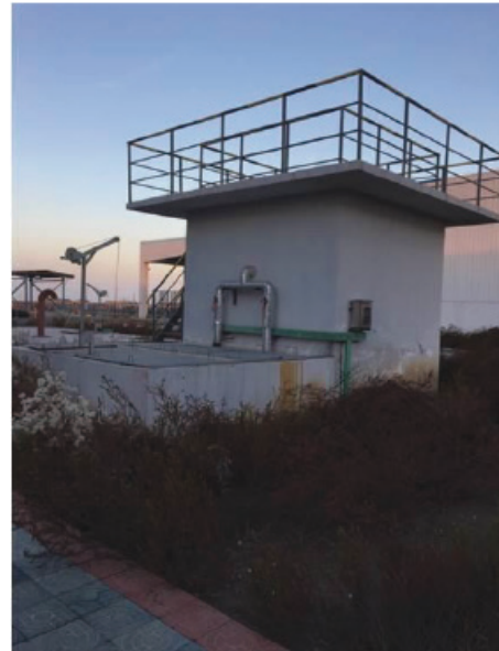
污水站—污泥槽
