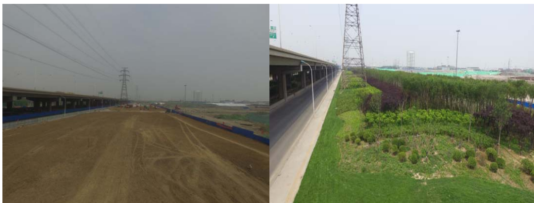
盐碱地修复：海港公园周边市政配套工程（排水明渠改暗涵工程和配套绿化工程）（修复前、后）
