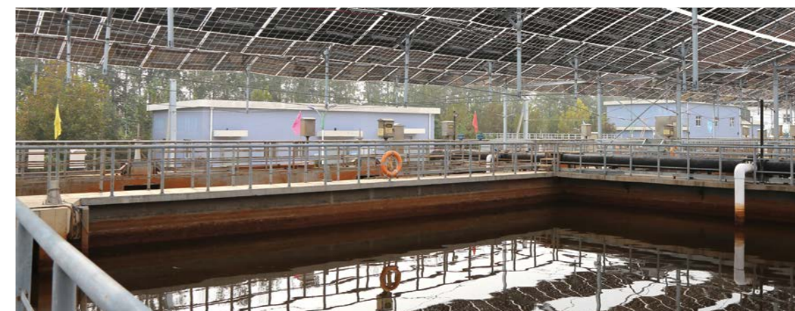
深州水廠分布式光伏發電站
