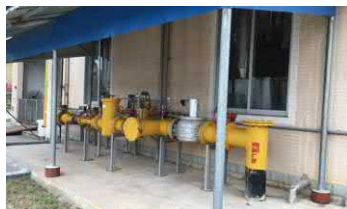
清洁燃料天然气管道
