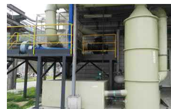
除臭设施增加玻璃钢喷淋塔
