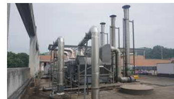
环保设施VOC治理生物处理设备
