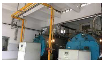
清洁燃料天然气锅炉
