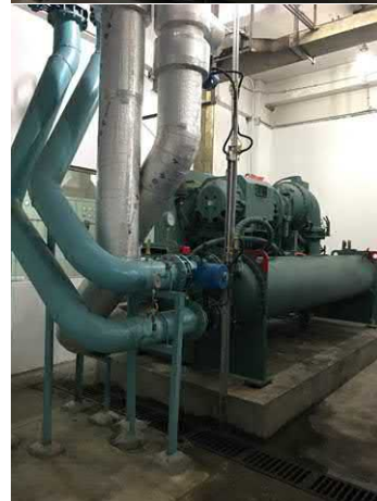
空调系统节能改造
