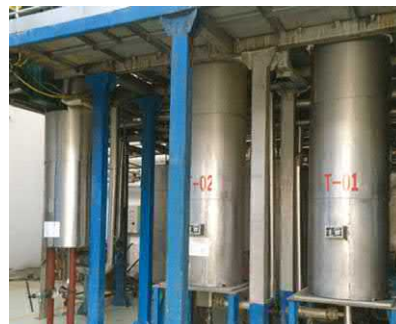
中水回用深度处理设施
