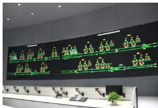
综合监控系统 (ISCS)
