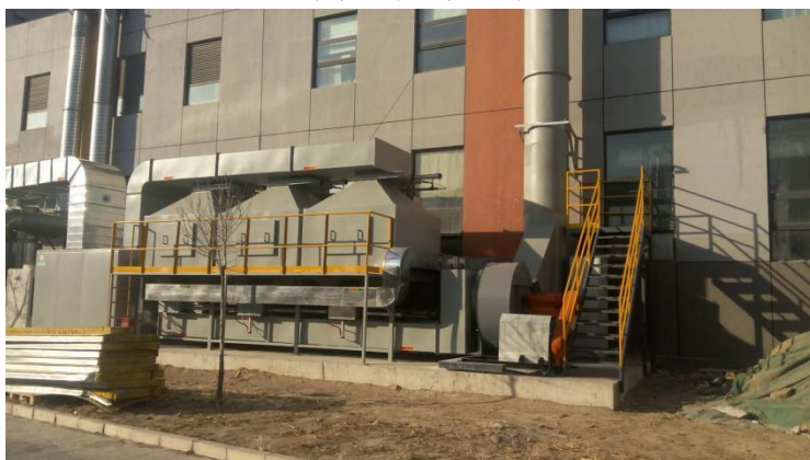
平张车间新印刷废气治理设施-008
