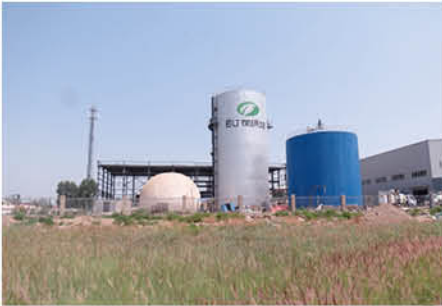
KLE 在银川的保绿餐厨垃圾水项目
