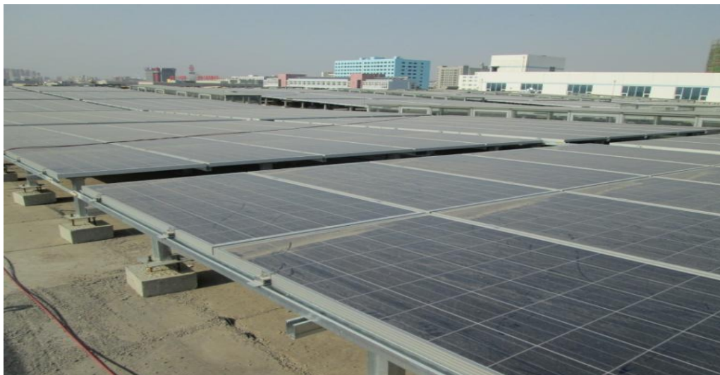
太阳能光伏发电项目
