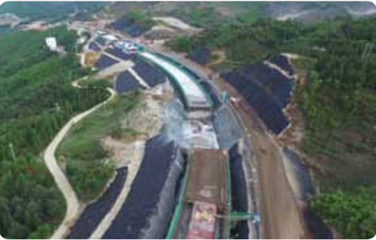
六盘水城市地下综合管廊
