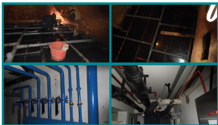
柳林大厦污水处理站改造后
